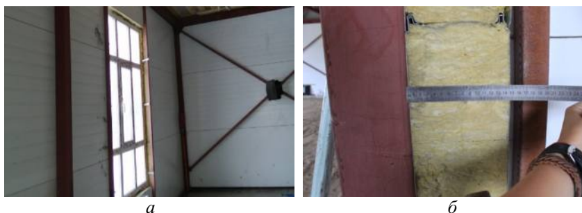
Рис. 3. Металлические связи стены в осях 4/А–Б и оконный проем в осях 3–4 по оси А (а) и вид навесных сэндвич-панелей с фактической толщиной t = 145 мм (б)
