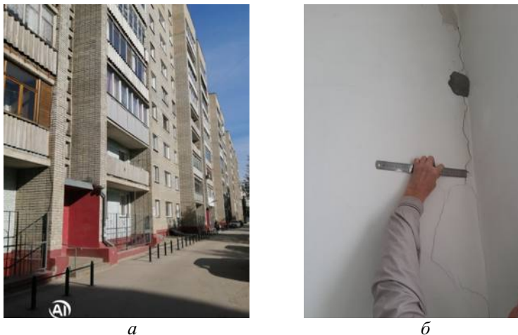
Рис. 1. Общий вид здания (а) и измерение трещин в несущих конструкциях (б)
